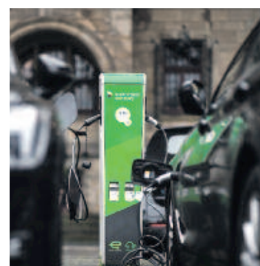
Ladesäulen befinden sich auch am Duisburger Rathaus. (Foto: Stadtwerke Duisburg)
